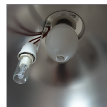
Дополнительная лампа аварийного освещения
