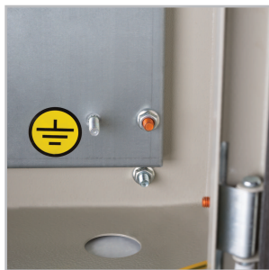
Шпилька заземления на монтажной панели.
