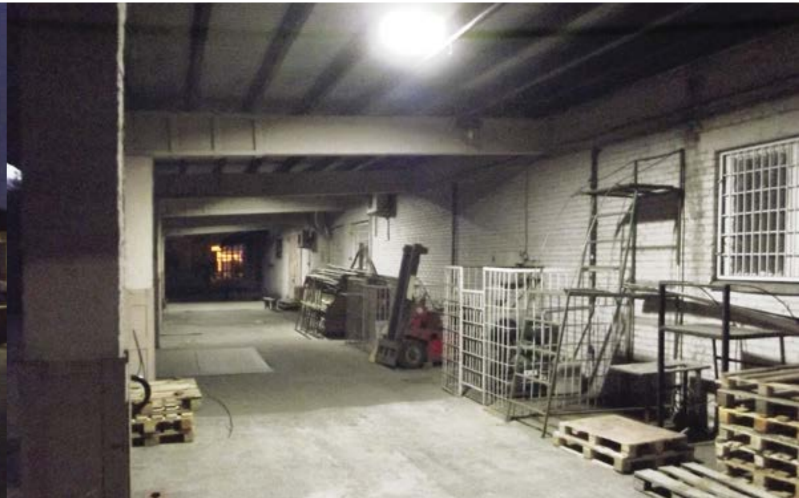
Освещение светильниками серии TUNNEL
