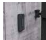
Фотоэлементы, установленные с внешней стороны объекта
