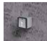
Ключ-выключатель, установленный с внешней стороны объекта
