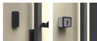
Фотоэлементы, установленные с внешней стороны объекта
