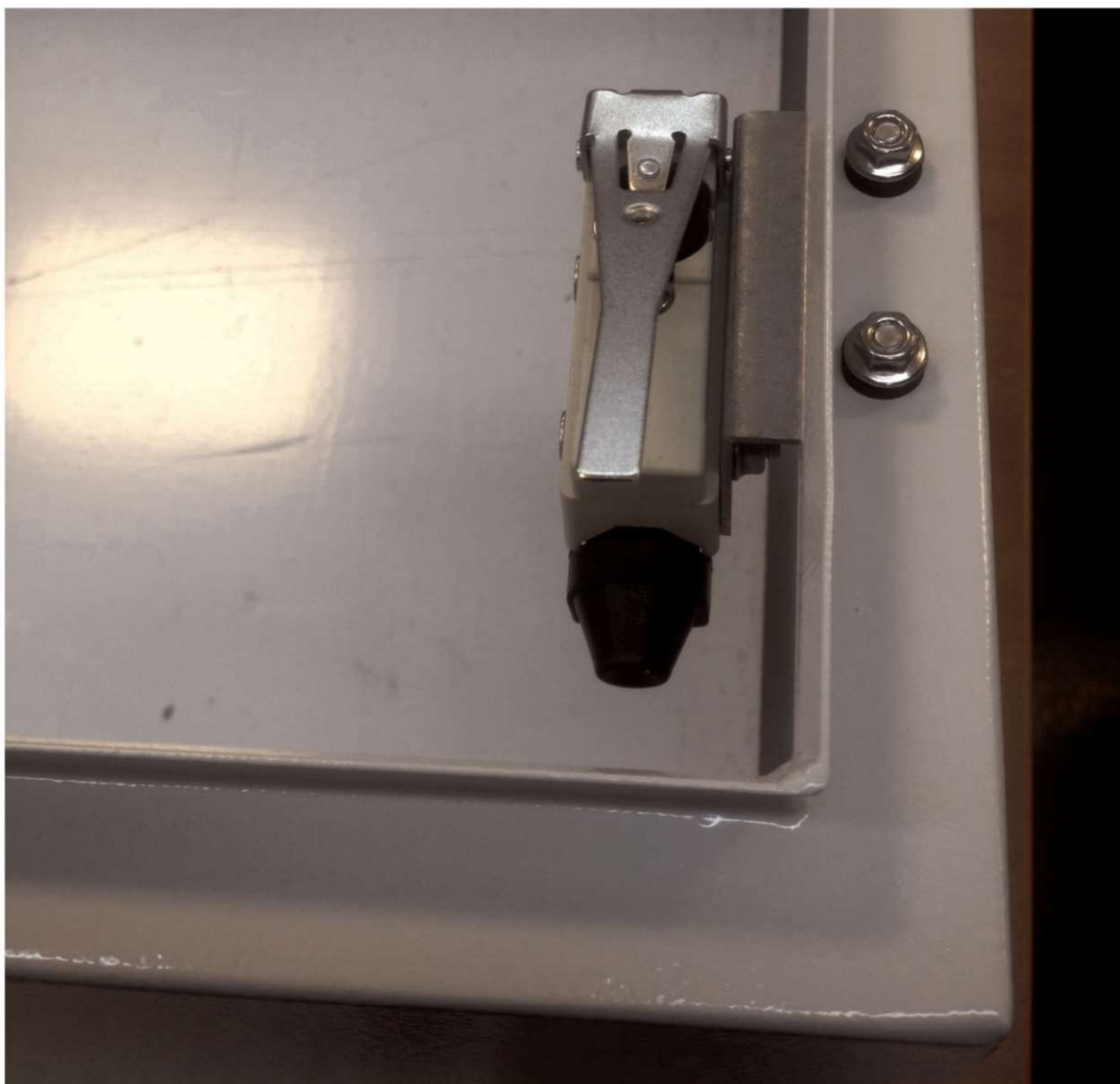
Рис.3.3.9.-1 Установленный выключатель вскрытия.
