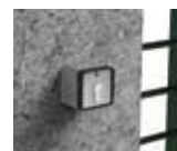
Ключ-выключатель, установленный с внешней стороны объекта
