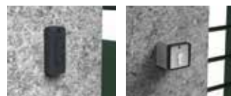
Фотоэлементы, установленные с внешней стороны объекта
